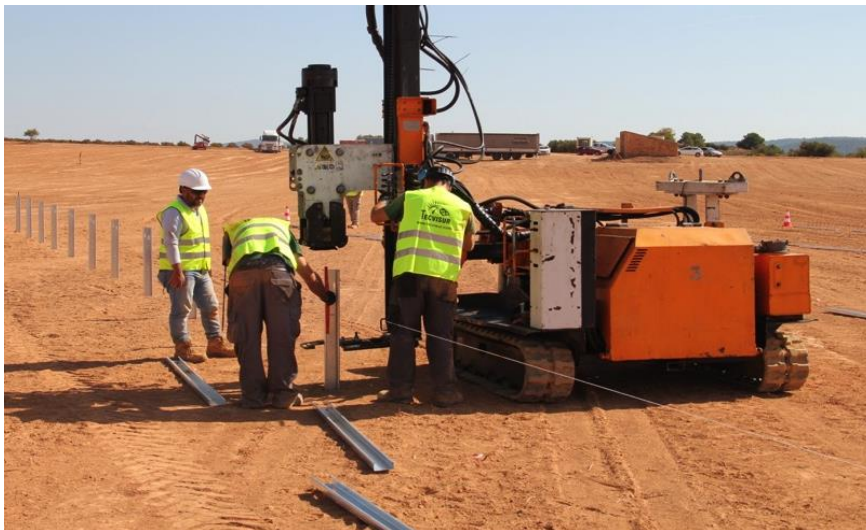
Die Unterkonstruktion wird in den Boden gerammt, Aufnahme vom 17.10.2017 (Fotos: Smartenergy Invest AG)
